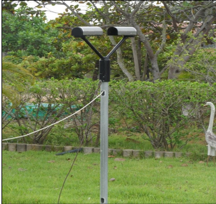
Figura 3.2 – Disdrômetro OTT Parsivel2 localizado na área externa do sistema de radar meteorológico de Alagoas
