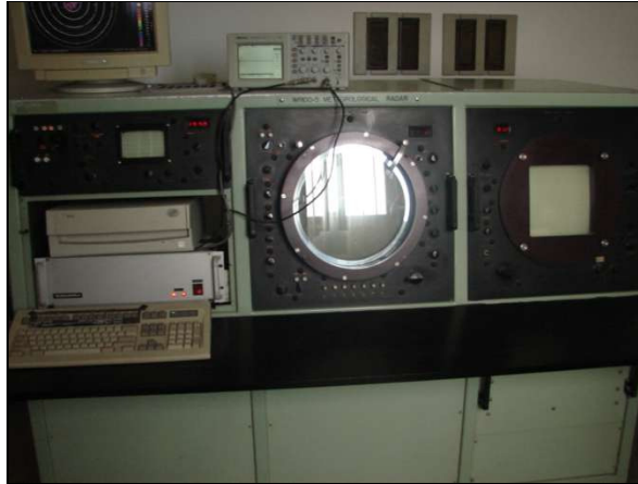
Figura 4.7 – Painel de controle e visualização analógica do sinal do radar. À esquerda embaixo módulo de digitalização do SASSANDRA.
