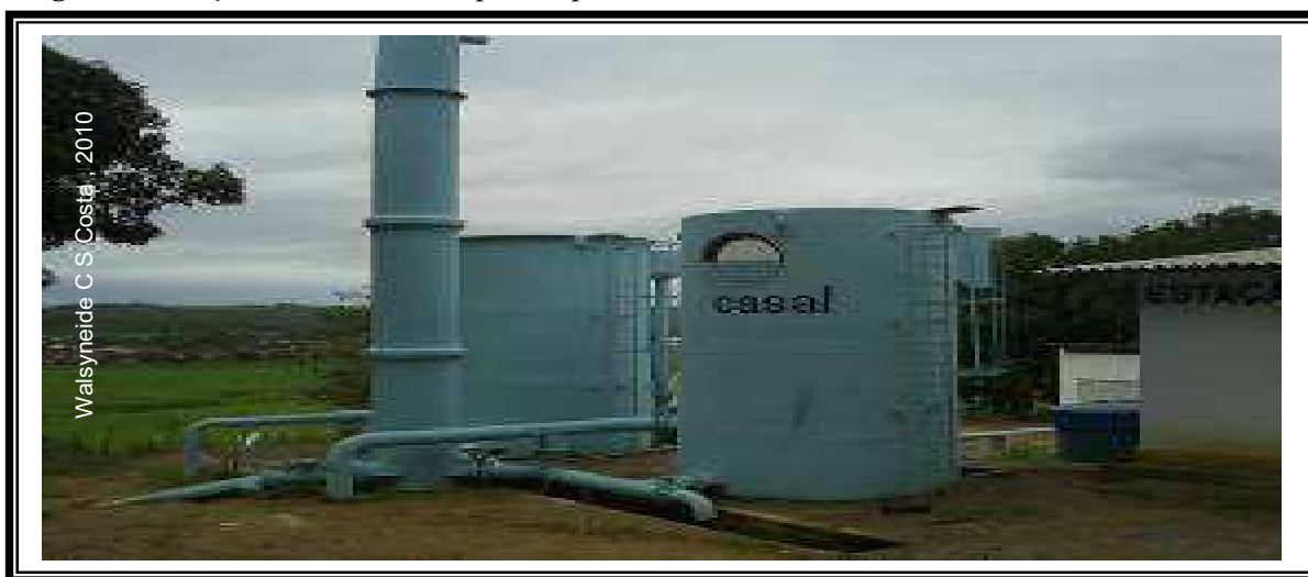
Figura 9: Estação de tratamento: tipo compacta.
