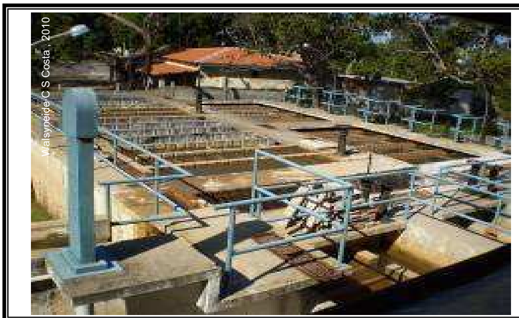
Figura 19: Estação de tratamento: Tipo convencional.
