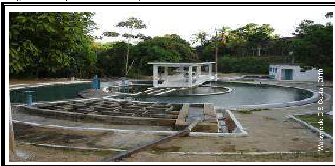
Figura 14: Estação de tratamento: Tipo caracol.
