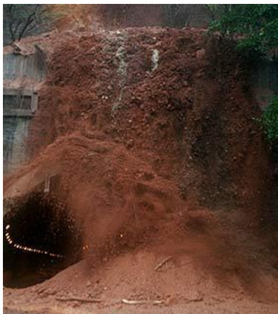
Figura 8 - Mostra o Túnel Rebouças e o deslizamento de terra sobre ele.
